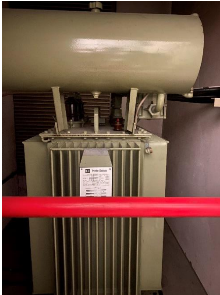
Alter Trafo mit obenliegendem Ölbehälter
