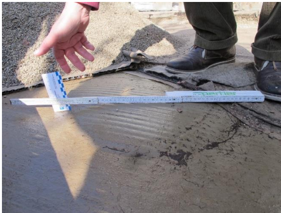
Prall gefüllte Blase zwischen Beschichtung und Grundierung
