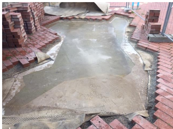
Eine sehr große Blase, entstanden aus vielen kleinen und zusammengewachsenen Blasen. Der Boden wurde neu abgedichtet. Die Steine neu verlegt.
