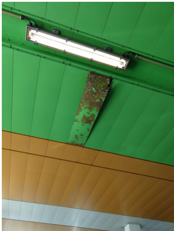
Rost auf Grund einer zu dünnen Beschichtung auf der Rückseite.
