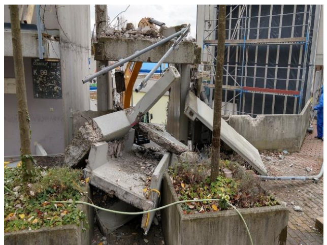
Abgestürzte Betonteile, Fußgängerebene Connollystraße
