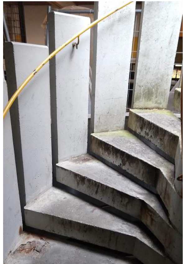
Salzgeschädigter Beton an der Spindeltreppe.
